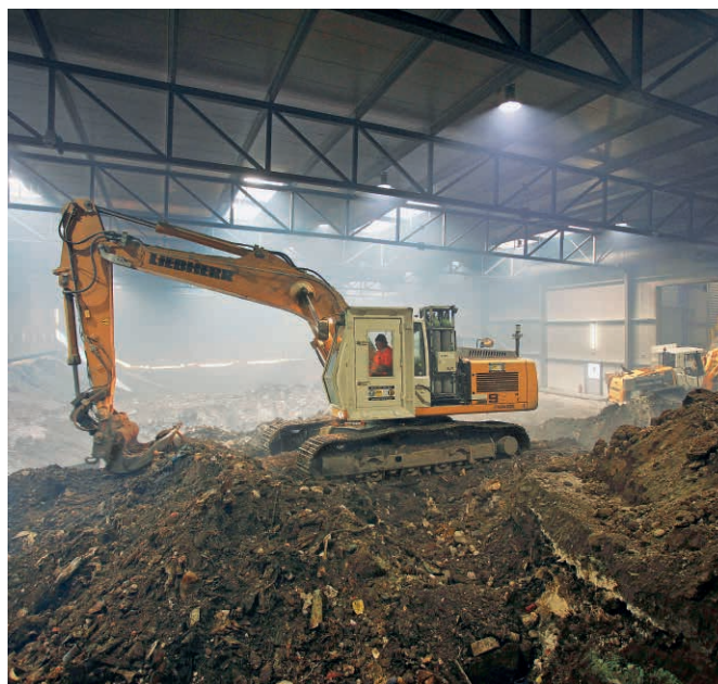
Abb. 36 Der Rückbau der Chemiemülldeponie Pont Rouge in Monthey (VS) erfolgte in einer verschiebbaren Sanierungshalle.
