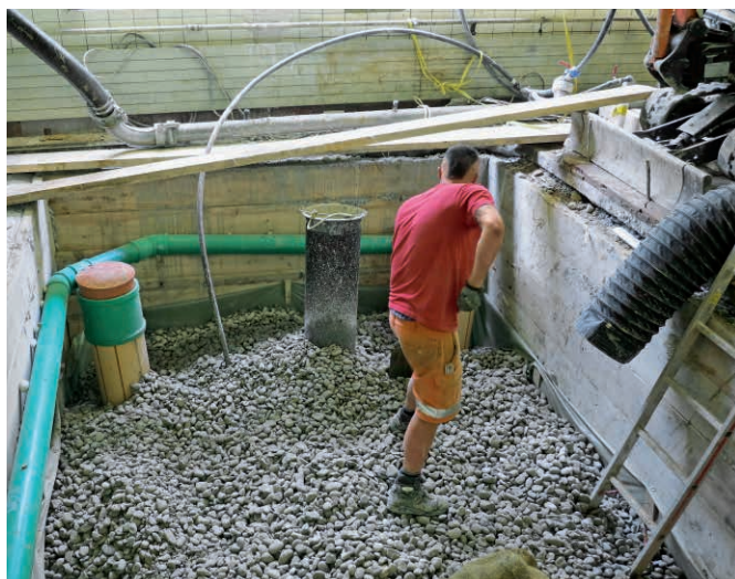
Abb. 33 Die eingebauten Rohre im Sanierungsbrunnen dienen dazu, das mit CKW belastete Grundwasser abzupumpen und die verunreinigte Bodenluft abzuzugeln.
