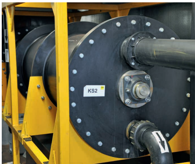
Abb. 42 Das abgepumpte Grundwasser durchläuft eine Strippanlage und die CKW werden dabei entfernt.
